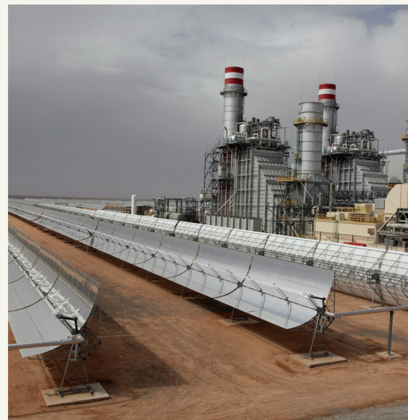
O BAD apoiou o desenvolvimento da Central Termo-Solar de Ciclo Combinado de Aïn Béni Mathar em Marrocos
